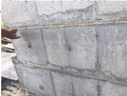
图8 1:1 试件拆模的表现状态
